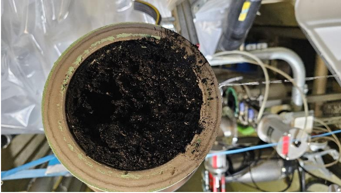
Conduite épaisseur bouchée
